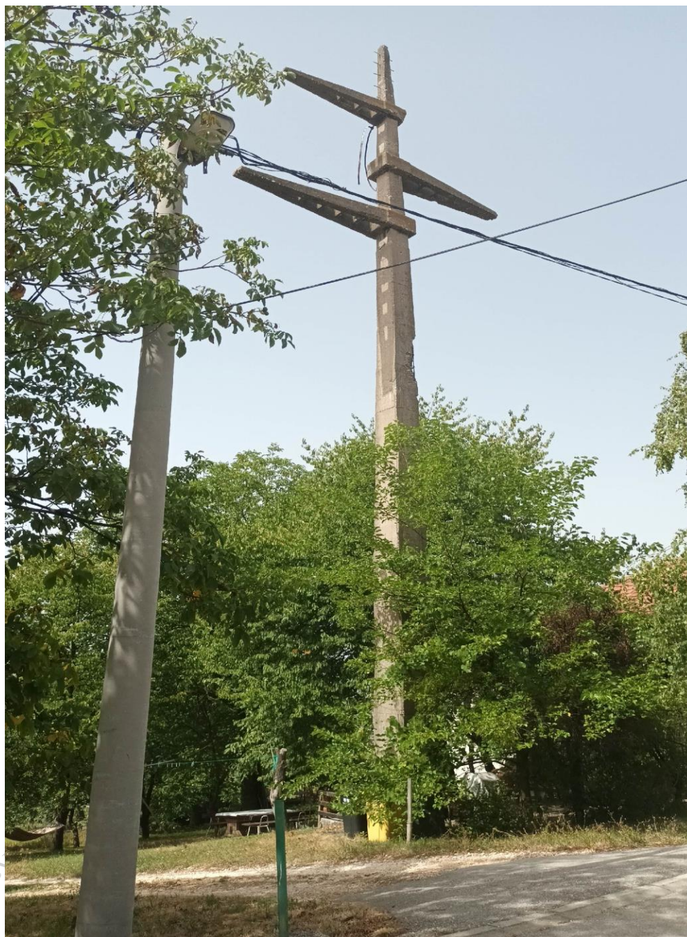
Fotografija 1 – Napušteni betonski stub (sa napuštene trase DV TS Sarajevo 1 – TS Goražde 1)
